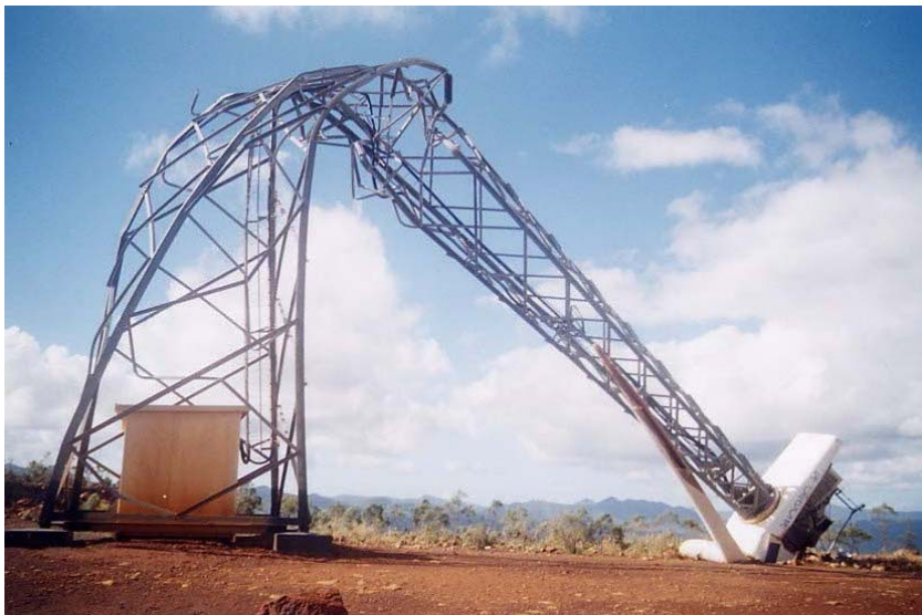
Figure 1.1 : Dégât sur une éolienne sans dispositif anticyclonique
