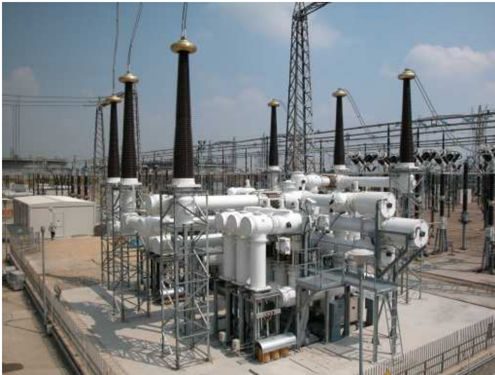
Appareillage blindé utilisé à 420 kV.
