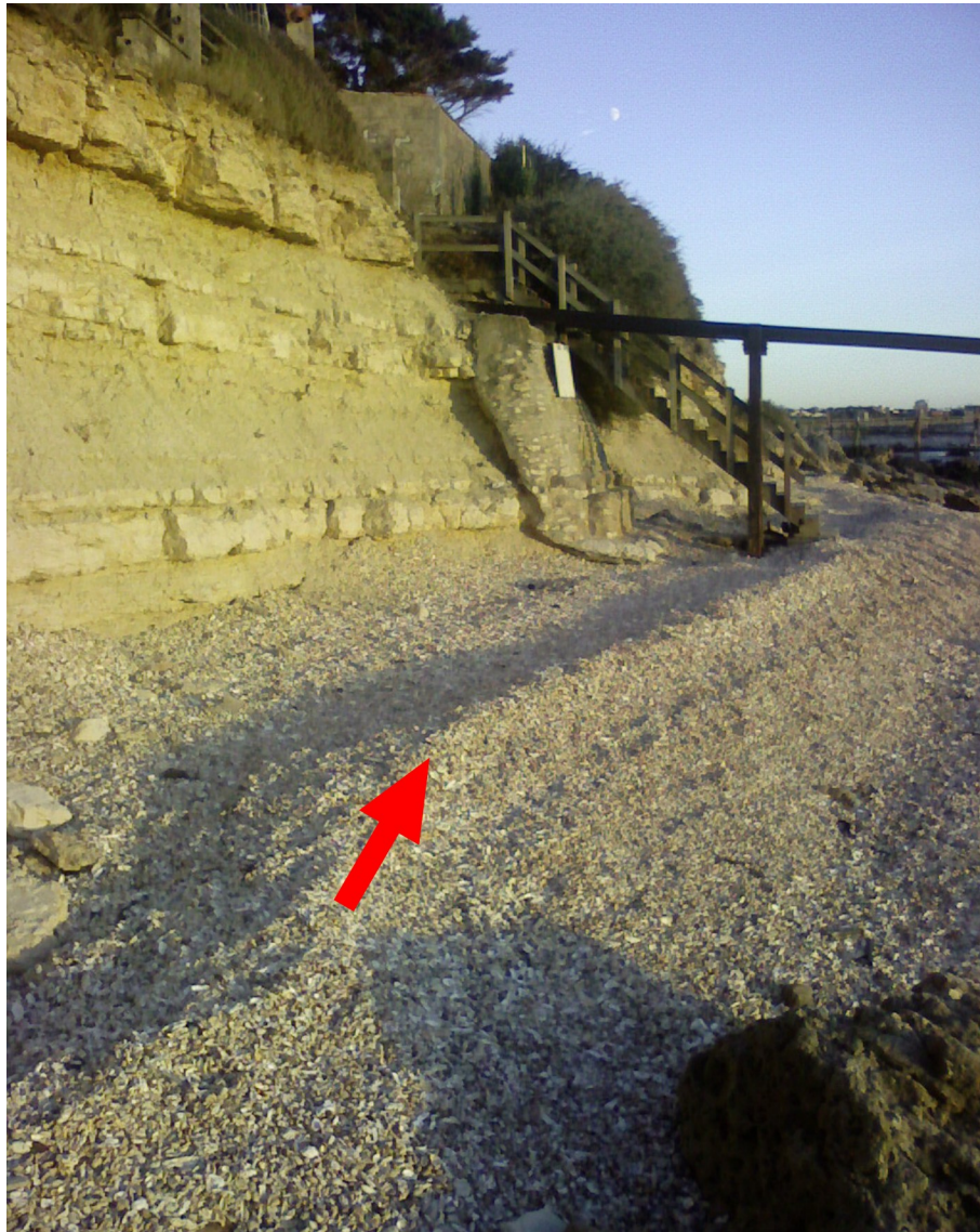
FIGURE 4.9 – Accumulation de coquilles de Crepidula fornicata et Crassostrea gigas au pied des falaises de la Pointe du Chay (Angoulins sur Mer). Noter la présence d’une berme (flèche rouge) qui isole le pied de la falaise du déferlement des vagues pendant les hautes mers.
