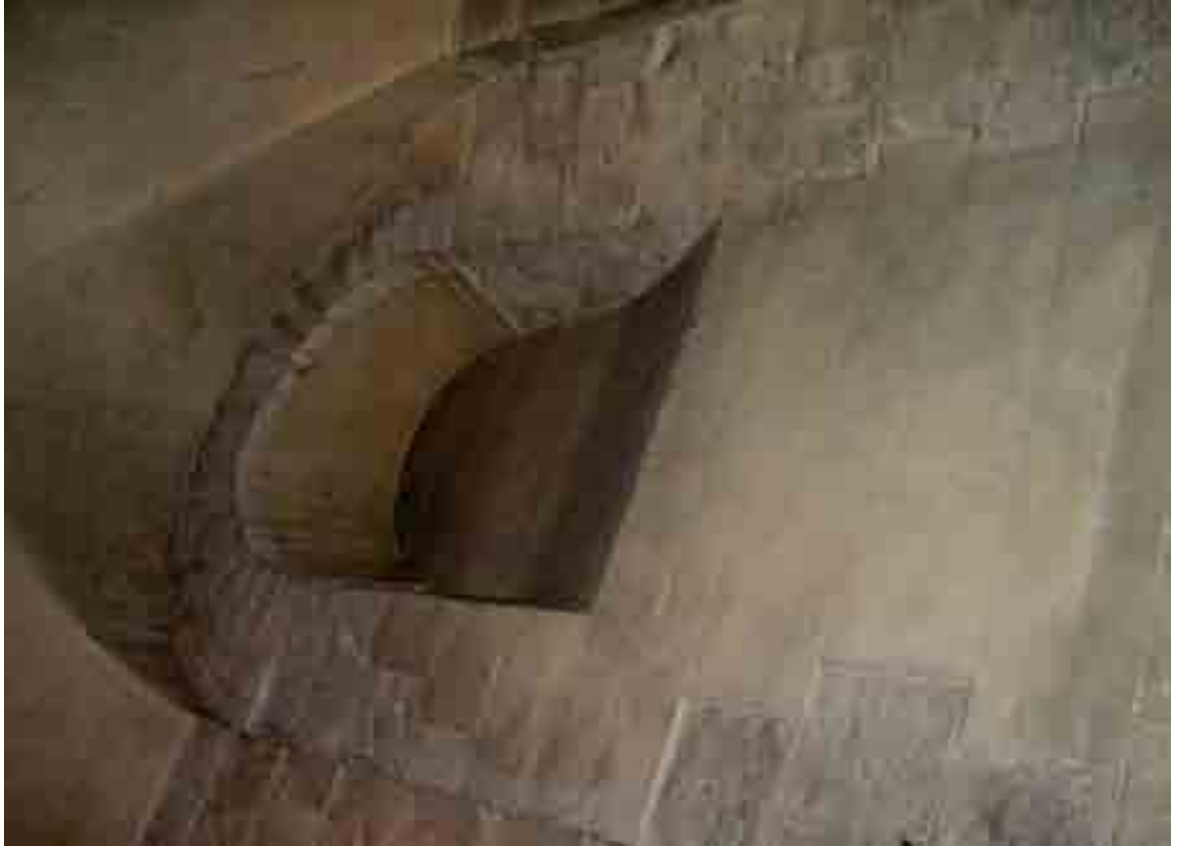
Fig. 221 - Mehun-sur-Yèvre, église Notre-Dame. Déambulatoire côté nord, deuxième travée, détail d'une ancienne baie condamnée.
