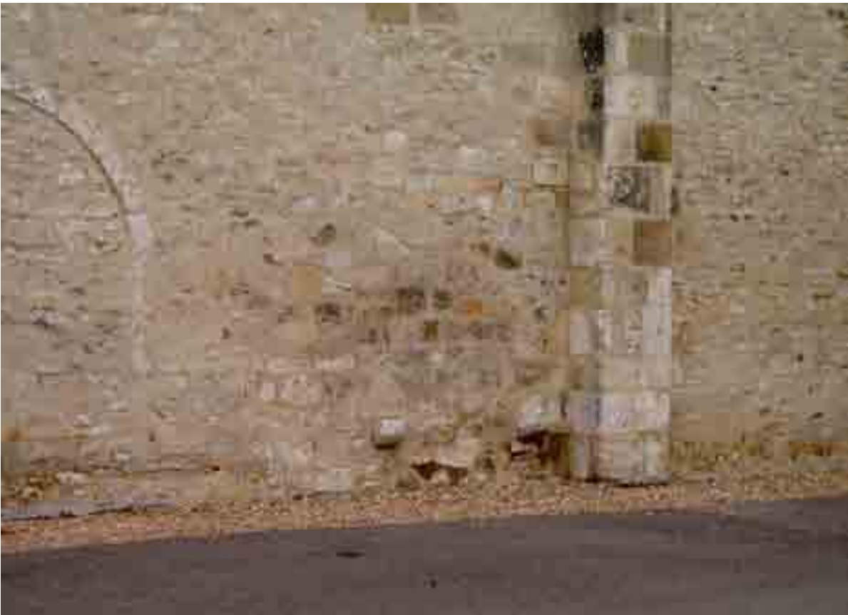
Fig. 204 - Mehun-sur-Yèvre, église Notre-Dame. Nef, mur sud (extérieur), quatrième travée, détail d'une perturbation de l'appareillage.
