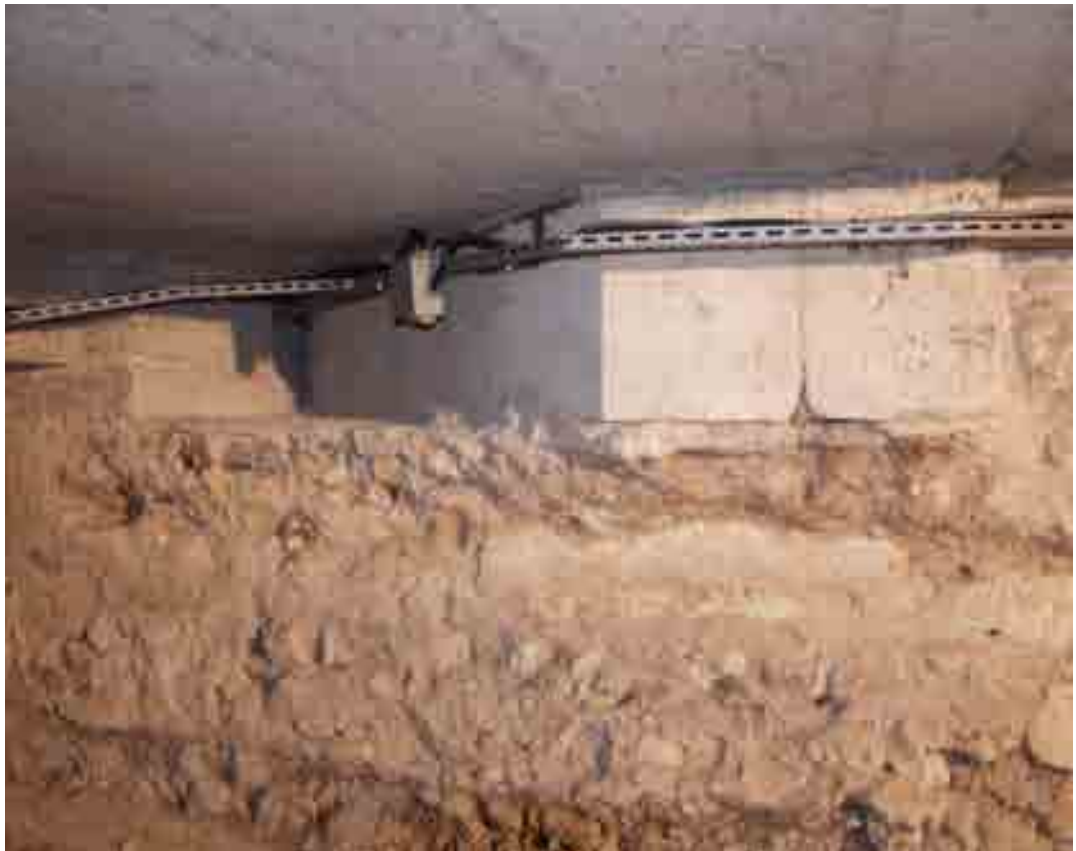
Fig. 307 - Châteaudun, église de la Madeleine. Sous-sol archéologique, base polygonale de la cinquième pile gothique, côté nord, face sud.
