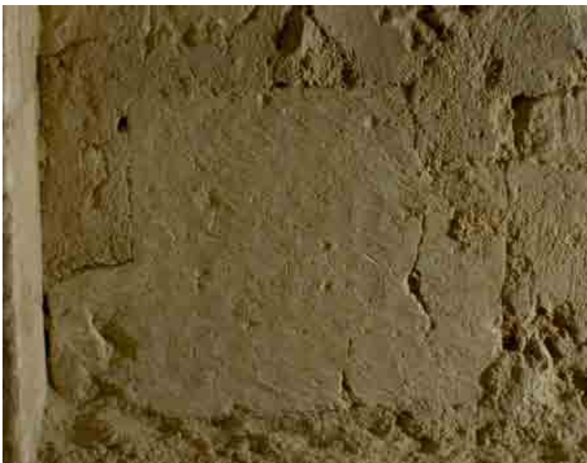
Fig. 297 - Châteaudun, église de la Madeleine. Sous-sol archéologique, maçonnerie moyen appareil (PIL 106), face sud. Détail d'un signe lapidaire (A).
