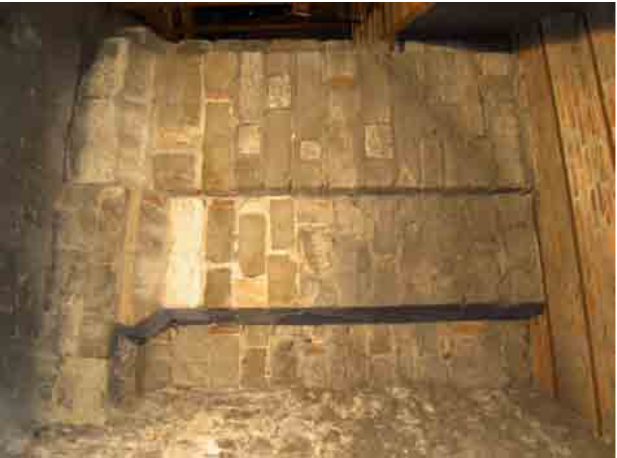
Fig. 391 - Orléans, cathédrale Sainte-Croix. Calorifère, jonction entre la première campagne et l'agrandissement du bras nord du transept.
