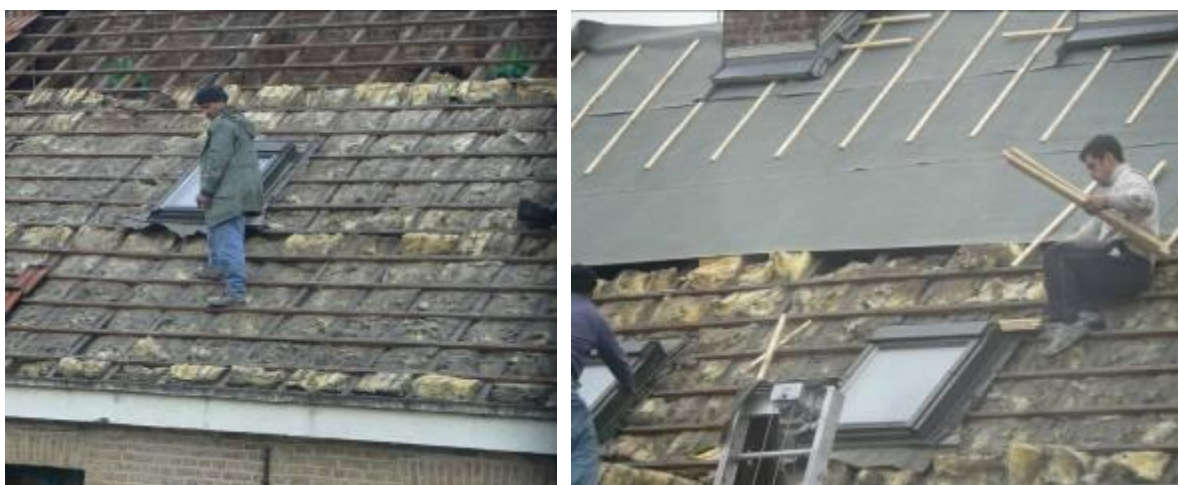
Figures 29 et 30 : Exemples de déconstruction / reconstruction avec remplacement des matériaux du système constructif sans respect des DTU & normes, [WIGNACOURT, 2008].
