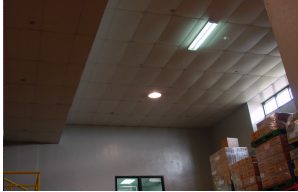
FIG. 6.1 – Photographie de plaques de plâtre en climat très humide ayant commencé à fluer sous leur propre poids (photo Lafarge).
