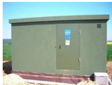
Figure 1-13 : Poste de livraison
