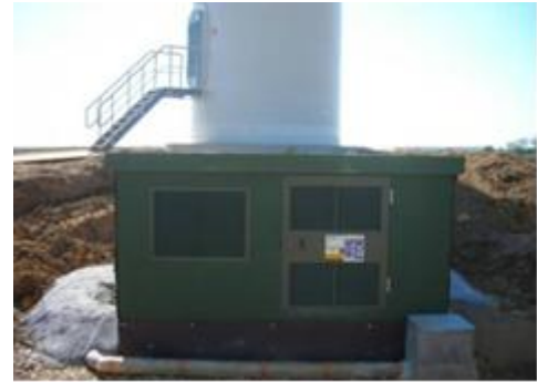
Figure 1-11 : Poste de transformation
