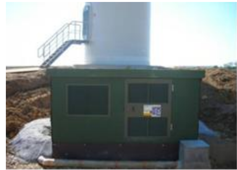
Figure 1-11 : Poste de transformation
