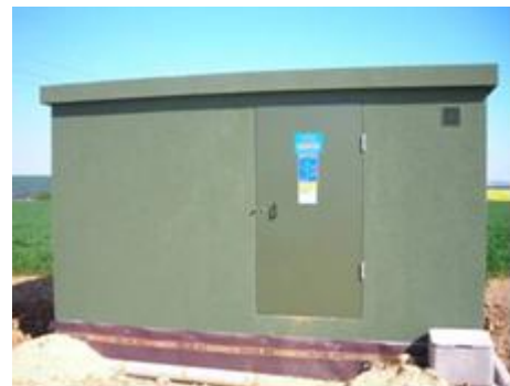
Figure 1-13 : Poste de livraison
