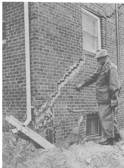
Figure 4: Exemple de dégât induit par le retrait du sol (Foth, 1990)
