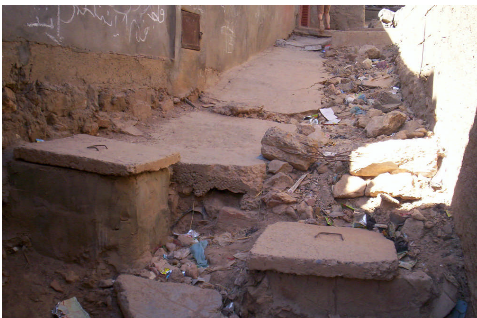
Figure 6-3 : des regards réalisés par les habitants sur un passage étroit pour les eaux usées au niveau des passages au bidonville de Ain El Beida (septembre, 2008).
