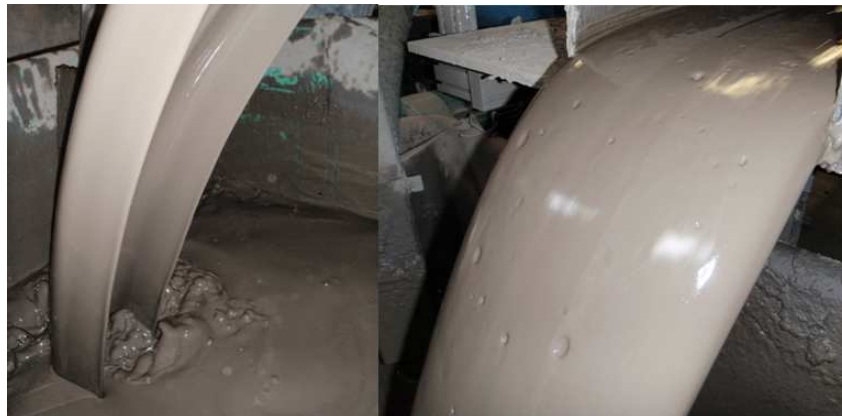
FIGURE 8.1 – Cascade de boue à l'exutoire du canal.
