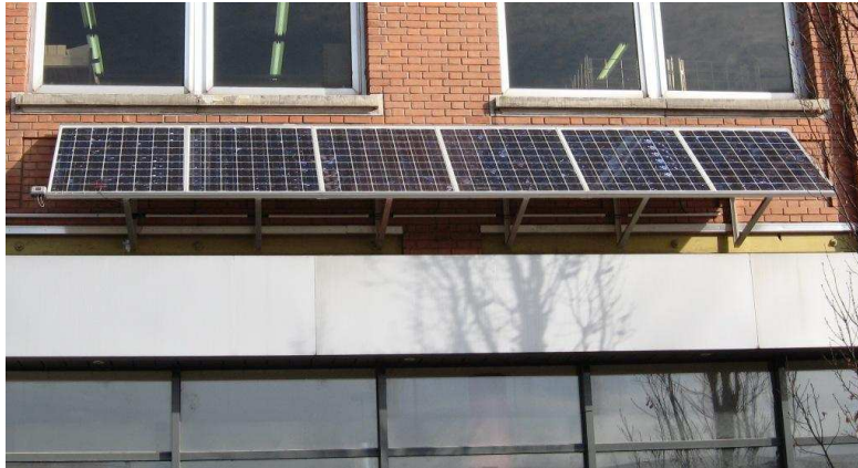
(a) PV installé sur la façade de la plate-forme d'essai du laboratoire
