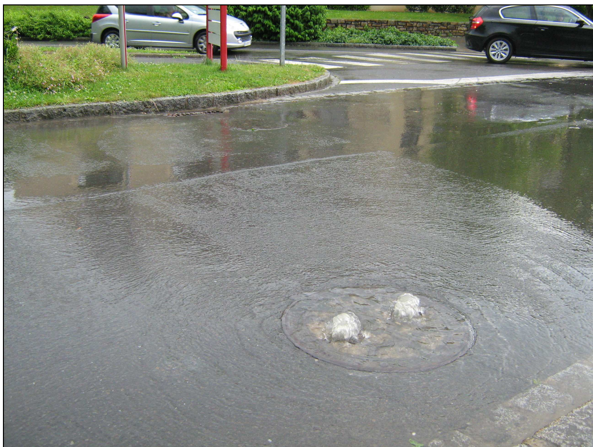
Photographie 26 : Débordement de réseau à Saint-Grégoire lors des pluies orageuses du 30/06/2009 (Crédit photographique : Janique Valy, le 30/06/2009)
