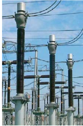
Fig. 3-24 : Alstom OSKF 765 current transformer
