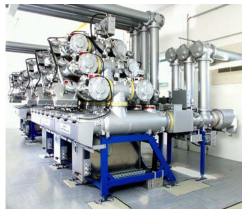
Fig. 1-4 : Alstom Grid 72.5 kV GIS B65
