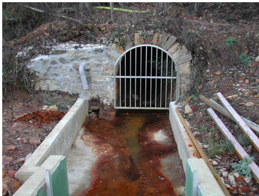
Photographie 3. Eau de drainage minier acide sur l'ancien site minier de Chessy (Rhône)
