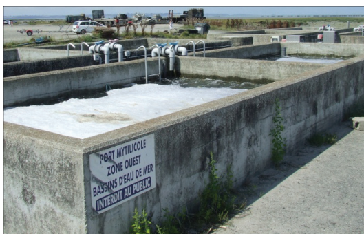
Fig. 19 : Bassins de purification (2009)
