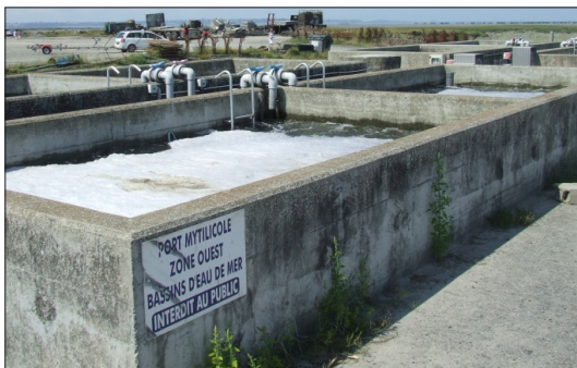
Fig. 19 : Bassins de purification (2009)
