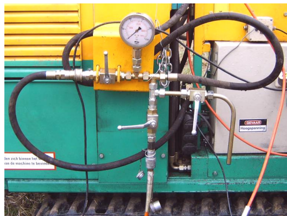
Figure III-11. Branchement de la pompe au circuit
