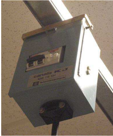
Figure 7-15. Alimentation prise sur Canalis
