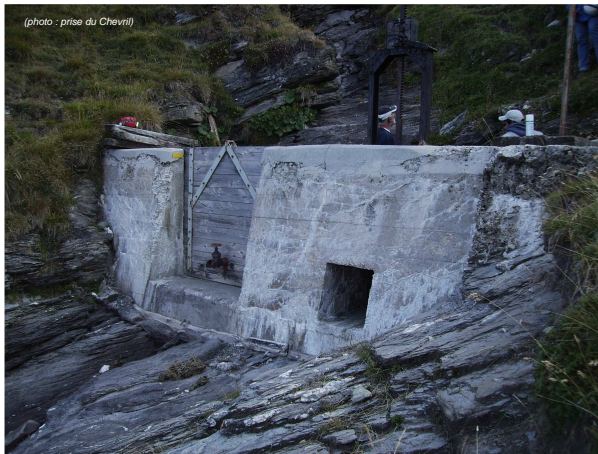
(a) vanne du débit réservé (à gauche) et de vidange (à droite)
