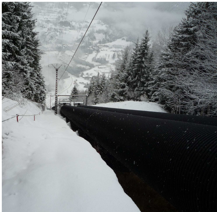
FIGURE 1.21 – Conduites forcées de Malgovert. Hauteur de chute dépassant les 900m. (le 18/01/09).
