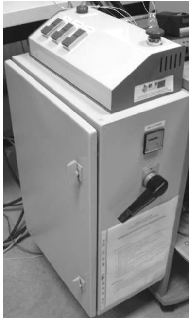
Figure 155. Armoire électrique pour l'alimentation des principaux organes de contrôle du banc.
