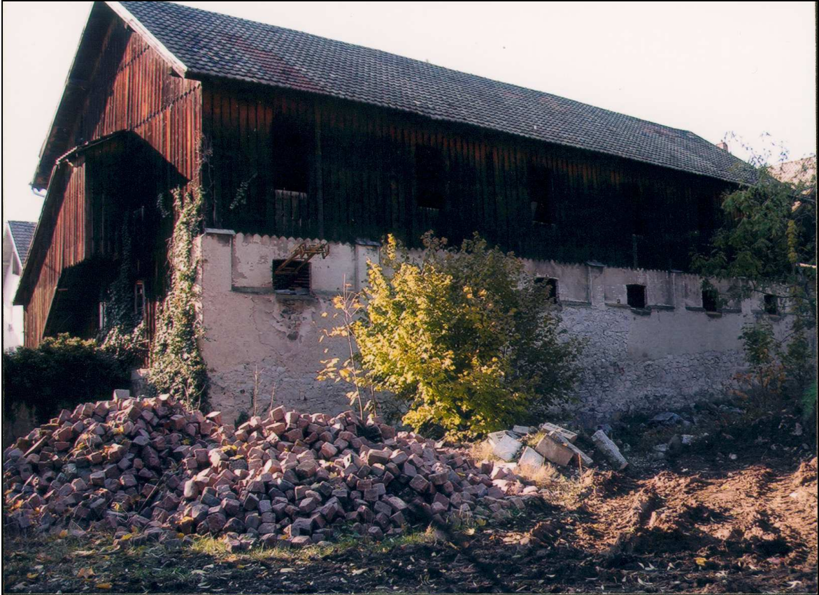
Fig. 72. Hangar industriel à Jungholtz qui servait à stocker les moules et autres matières premières ainsi que les produits finis (photo B. Risacher)
