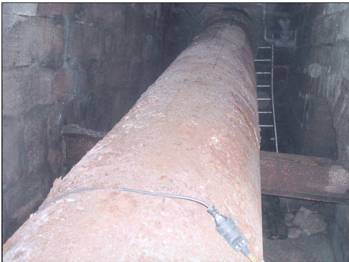
Fig. 81. La conduite forcée en place dans la coursière de l'ancienne papeterie de Jungholtz (photo B. Risacher)
