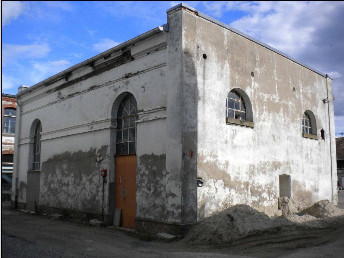
Fig. 74. La centrale d'énergie de la soierie Baumann à Sultz (photo B. Risacher)
