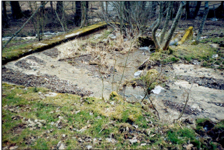
Fig. 82. Le petit réservoir de retenue de Rimbach-Zell, aujourd'hui comblé (photo B. Risacher)
