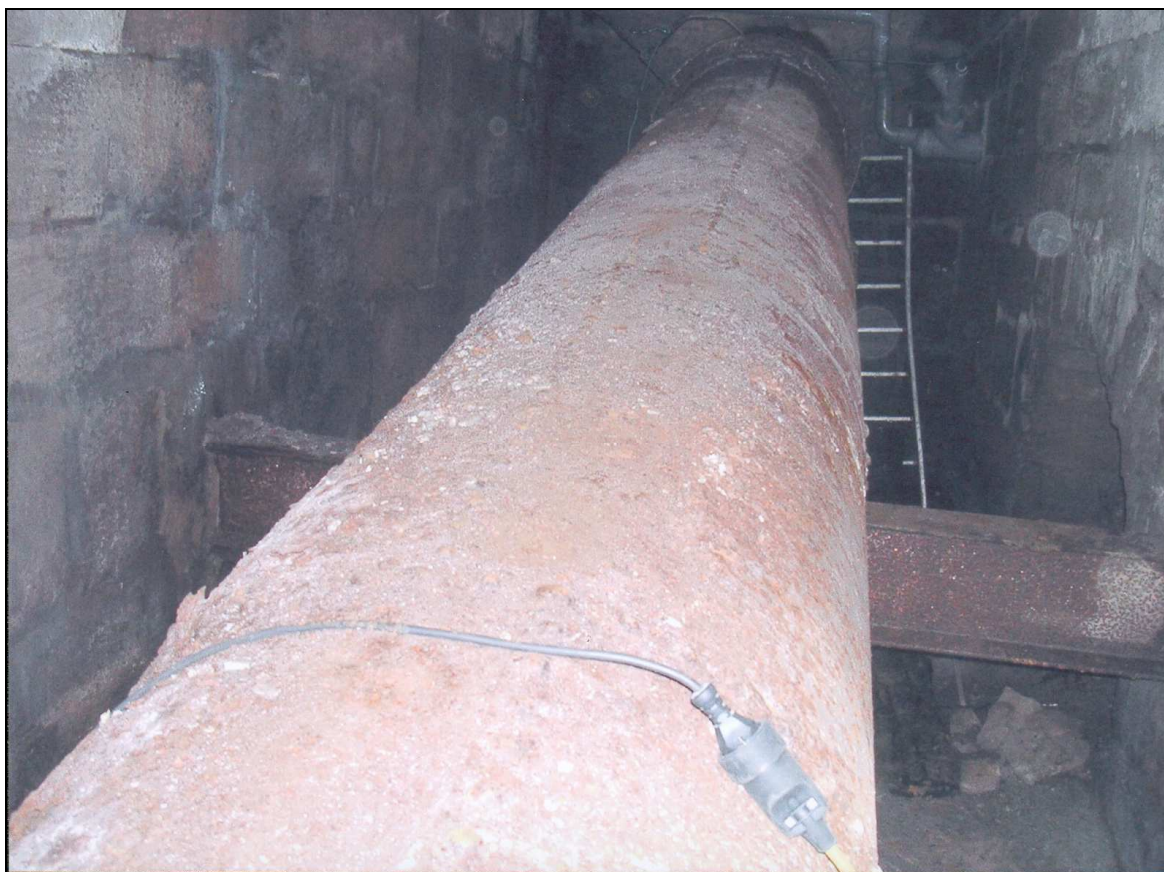
Fig. 81. La conduite forcée en place dans la coursière de l'ancienne papeterie de Jungholtz (photo B. Risacher)
