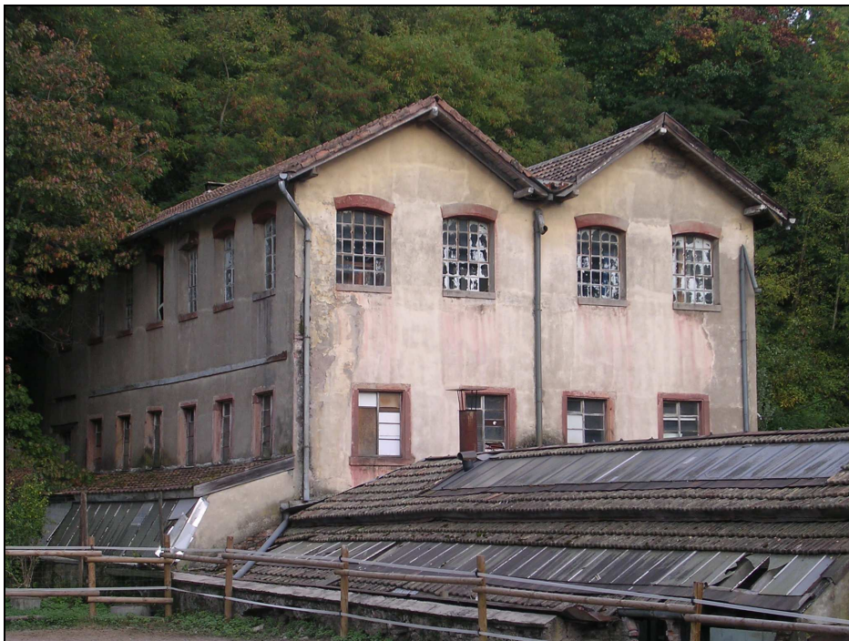
Fig. 68. L'usine bloc Latscha & Cie à Jungholtz. Il s'agit en fait de deux blocs accolés. L'usine semble avoir connu deux périodes : la configuration des fenêtres à l'étage du bas est plutôt XIX e , alors qu'en haut elle est représentative de la charnière XIX e /XX e siècles (photo B. Risacher)
