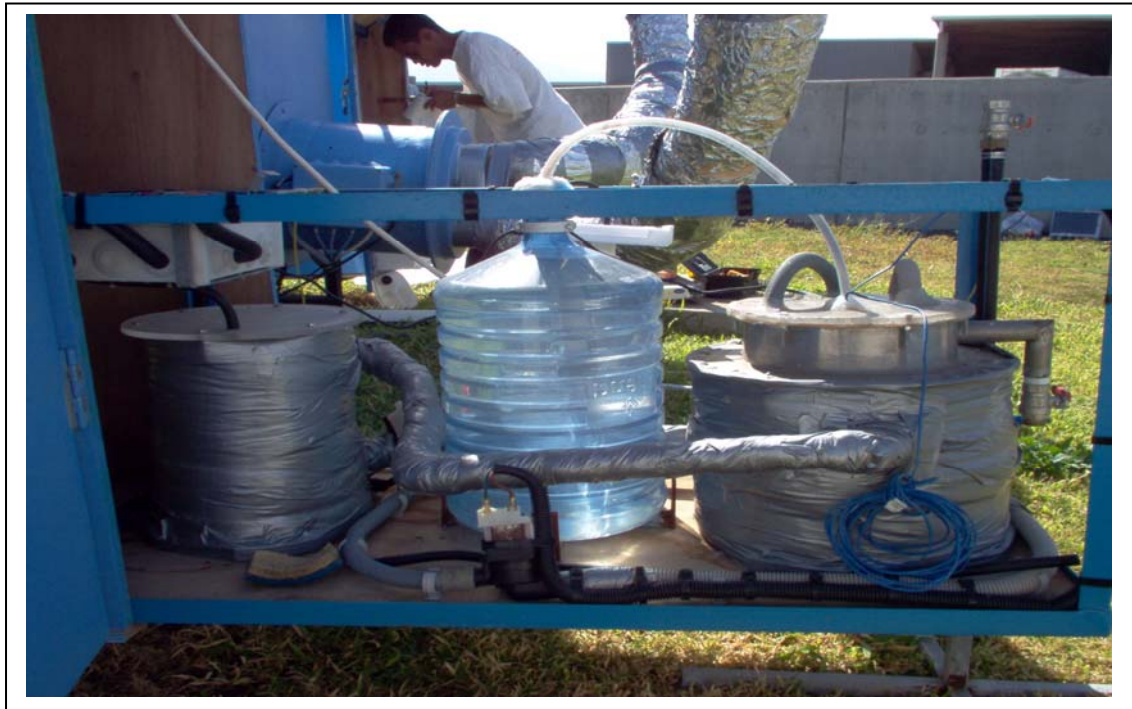
Figure II.41 : Dispositif à la station d'épuration
