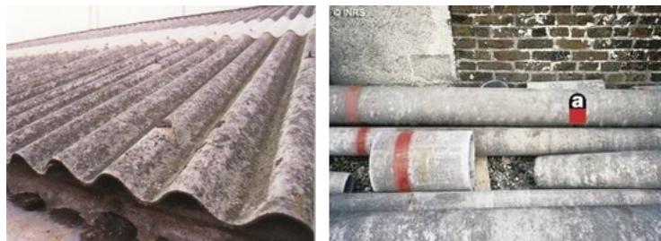
FIG. 1.12 – Tôles ondulées et tuyaux en amiante/ciment
