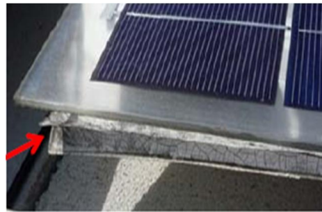
(h) défaut mécanique de la face arrière
