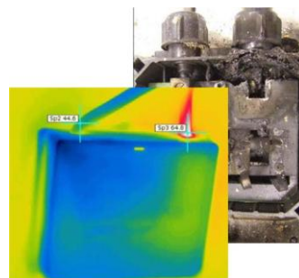
(b) corrosion dans la boîte de jonction
