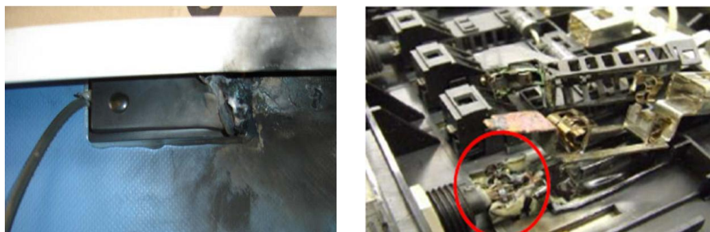
Figure A-2 : Exemples de défauts rencontrés dans des boîtes de jonction
