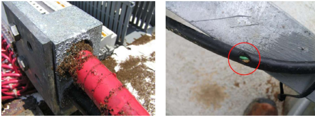
Figure A-3 : Exemples de défauts rencontrés dans le système de câblage
