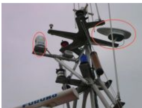
(a) On peut voir la caméra à gauche de l'image ainsi que la centrale inertielle satellitaire à droite de l'image. Le matériel est fixé sur le mat du bateau.
