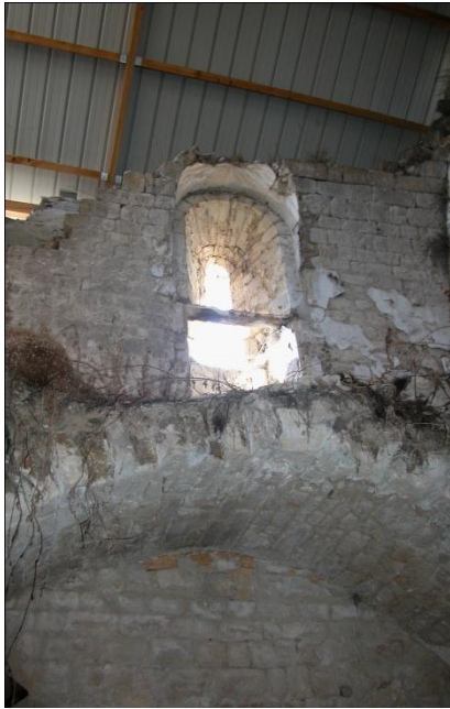
Fig. n° 111. Première travée de Saint-Jean : fenêtre à double ébrasement au-dessus de la voûte de la tribune (cl. M. Varano).
