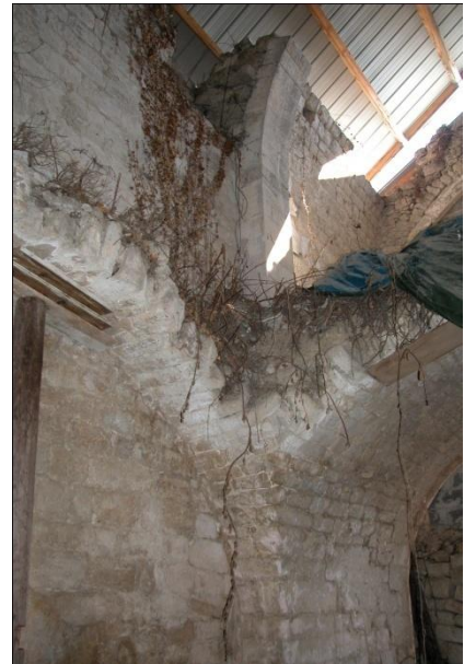
Fig. n° 117. Vestige de l'arc doubleau et de la tribune dans la partie ouest de l'église Saint-Jean (cl. M. Varano).
