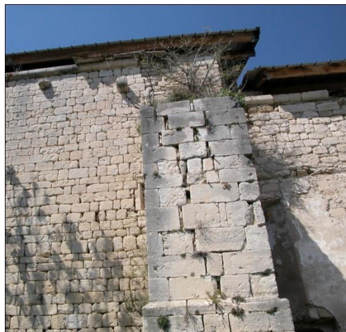
Fig. n° 112. Cassure sur le mur méridional de l'église Saint-Jean, au-dessus du contrefort (cl. M. Varano).
