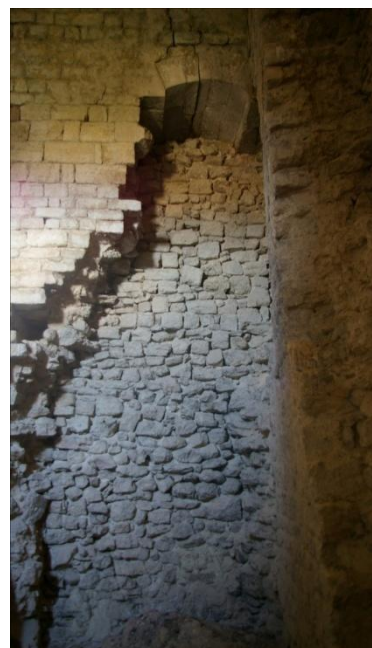
Fig. n° 82. Arc de la porte ouverte à l'étage de la « tour de l'évêque », visible uniquement de l'intérieur (cl. M. Varano).
