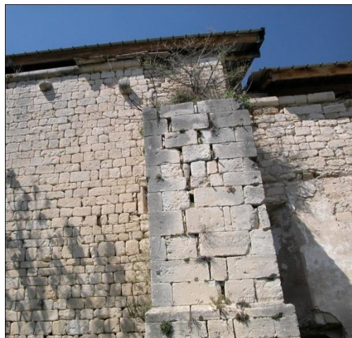
Fig. n° 112. Cassure sur le mur méridional de l'église Saint-Jean, au-dessus du contrefort (cl. M. Varano).
