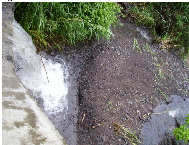
Figure 37 : Envasement d'un piège à sédiment par la charge des eaux d'écoulement profond
