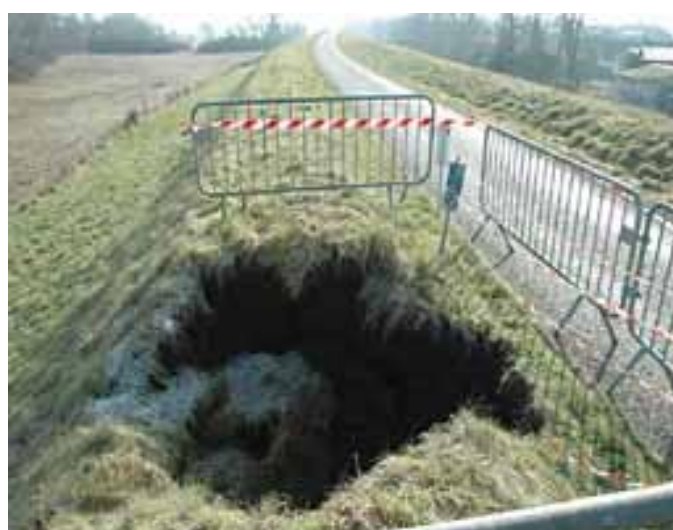
Figure 8 : Fontis créé sur la commune de Jargeau (Géosciences, BRGM)
