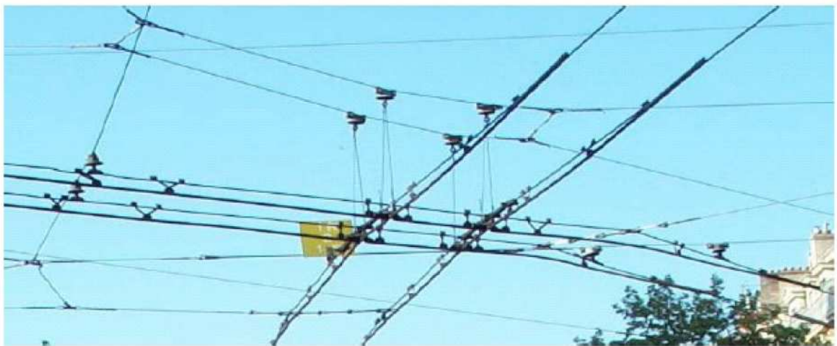
Figure 1.16 : Exemple de traversée sur la ligne d'alimentation du trolley.
