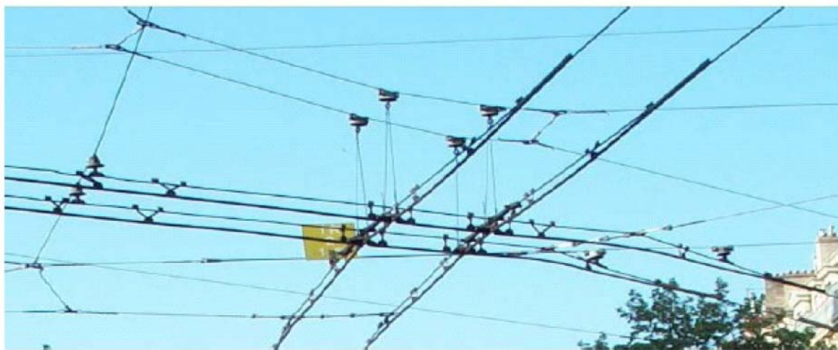
Figure 1.16 : Exemple de traversée sur la ligne d'alimentation du trolley.
