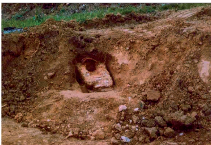
c : vue depuis le sud-est du tronçon d'aqueduc détruit lors d'un terrassement (cliché : C. Colas)
