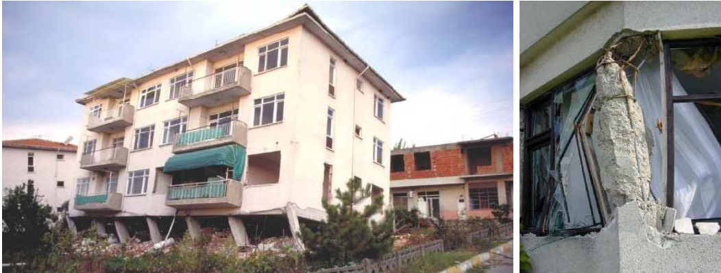
FIGURE 1.9: Exemples de ruptures localisées
