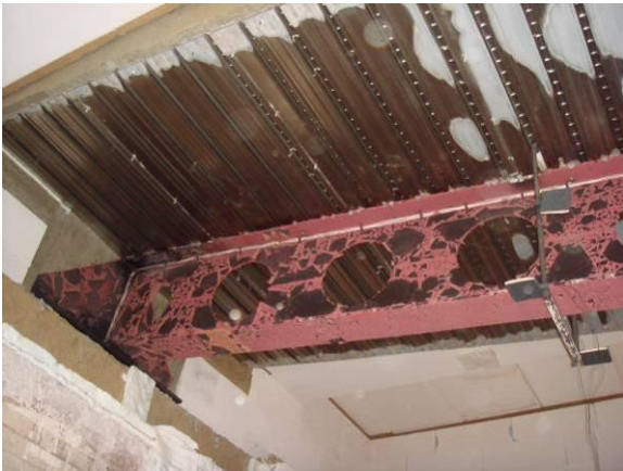
a) Extrémité après la ruine
