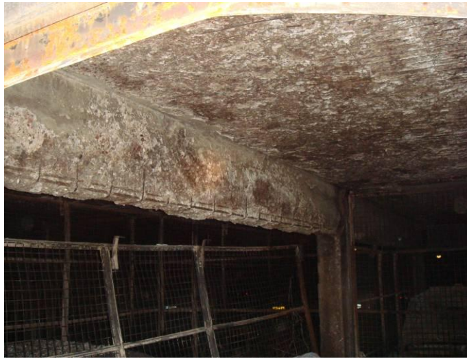
Figure 5.8 : Eclatement du béton suite à un incendie de parking
