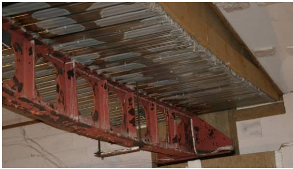
a) Extrémité après la ruine
