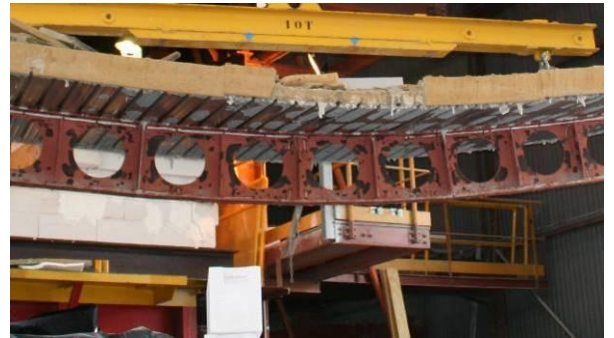
b) Partie centrale après la ruine
