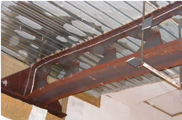
a) Extrémité après la ruine
