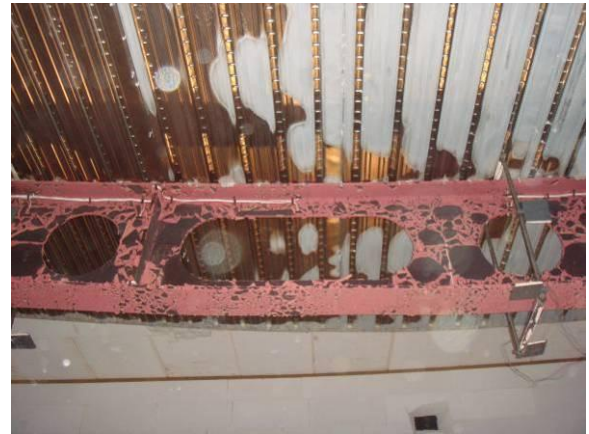
b) Partie centrale après la ruine
