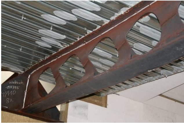
a) Extrémité après la ruine
