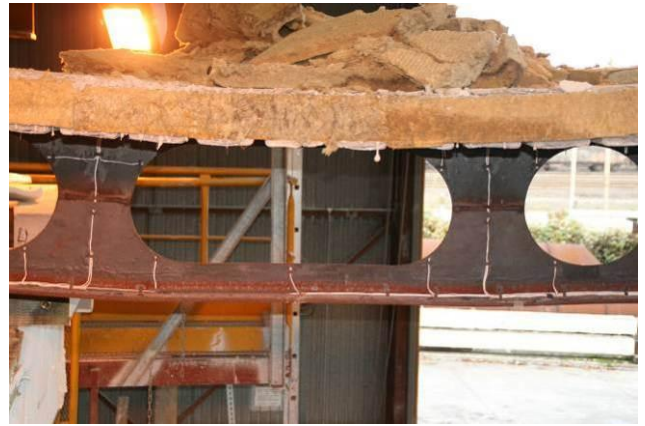
b) Partie centrale après la ruine
