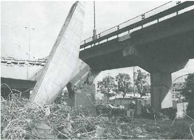
Figure 1-6 : Rupture d'une pile par flexion-cisaillement (Kobe, 1995), d'après [Priestley et al., 1996].
