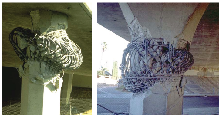
Figure 1-8 : Rupture de piles de pont par cisaillement lors du séisme de Northridge, 1994 (d'après [NISEE]).
