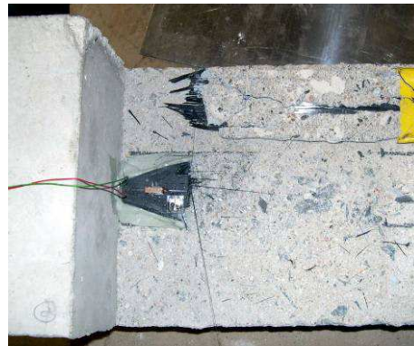
Figure A2- 18 : mode de rupture de la lamelle ancrée lors de l'essai CLA2i.
