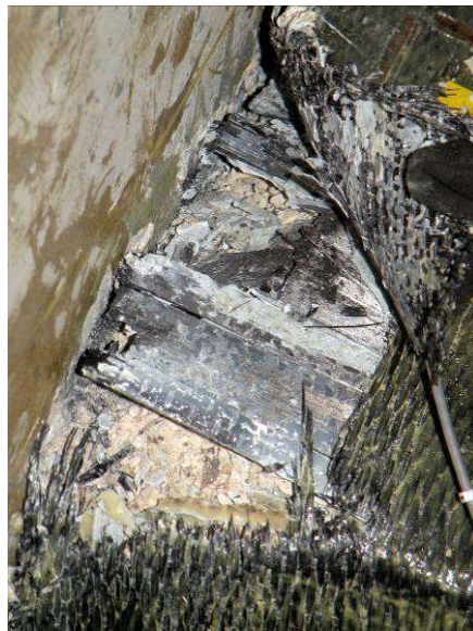
Figure 3-37 : Fin de l'essai sur PCLA2, les ancrages composites sont écrasés.
