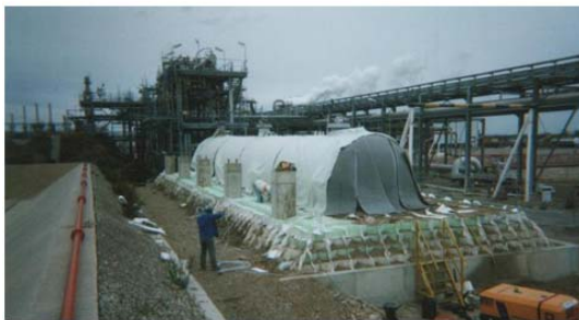
Confinement de cuve Arco Chimie, Fos sur Mer (13)
