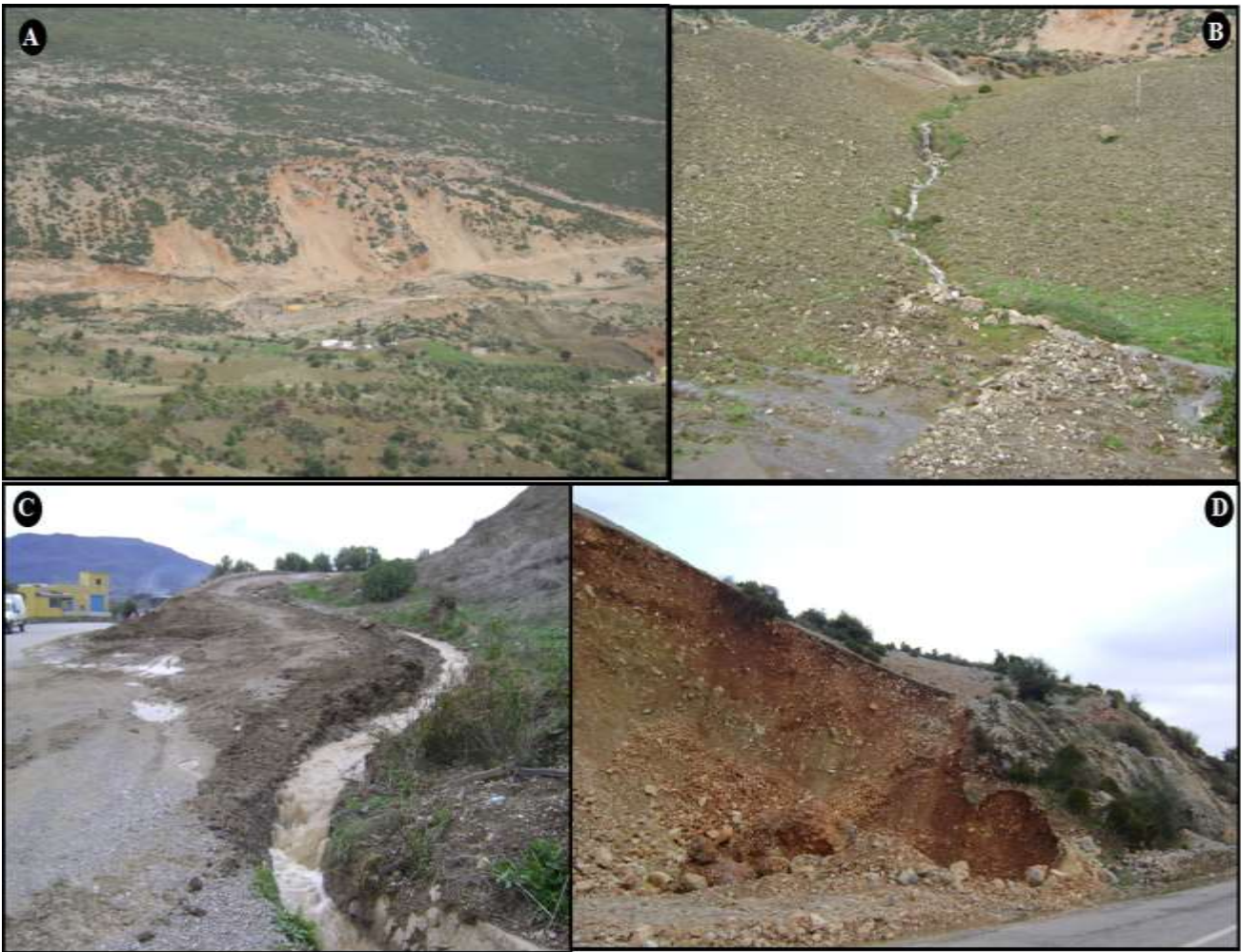
Figure IV-22 : A : Photo montrant les carrières exploitant les formations de grèzes à l'aplomb du glissement de Bou Halla ; B : Ecoulement de l'eau de la résurgence qui se fait parallèlement à la pente du versant ; C : Ecoulement de l'eau de source canalisé artificiellement ; D : Photo montrant les formations des grèzes litées.
