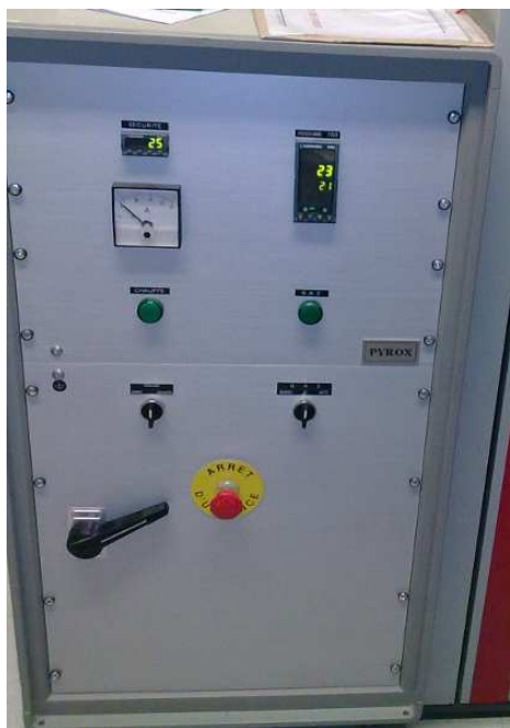
FIGURE 4.4: Vue du bloc de commande du four.
