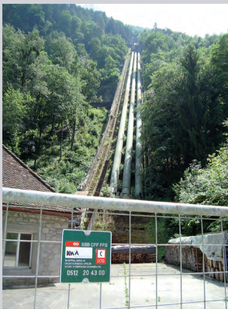
Photo 37. L'entreprise ferroviaire, un producteur d'énergie Vue de la centrale hydroélectrique d'Amsteg ouverte, pour permettre l'électrification de la ligne du Gothard et appartenant aux CFF. Photo K. Sutton, juillet 2010.
