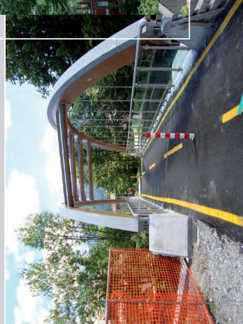
Viaduc ferroviaire rénové pour permettre le passage du bitume flambant neuf de la piste cyclable. K. Sutton, août 2010.
