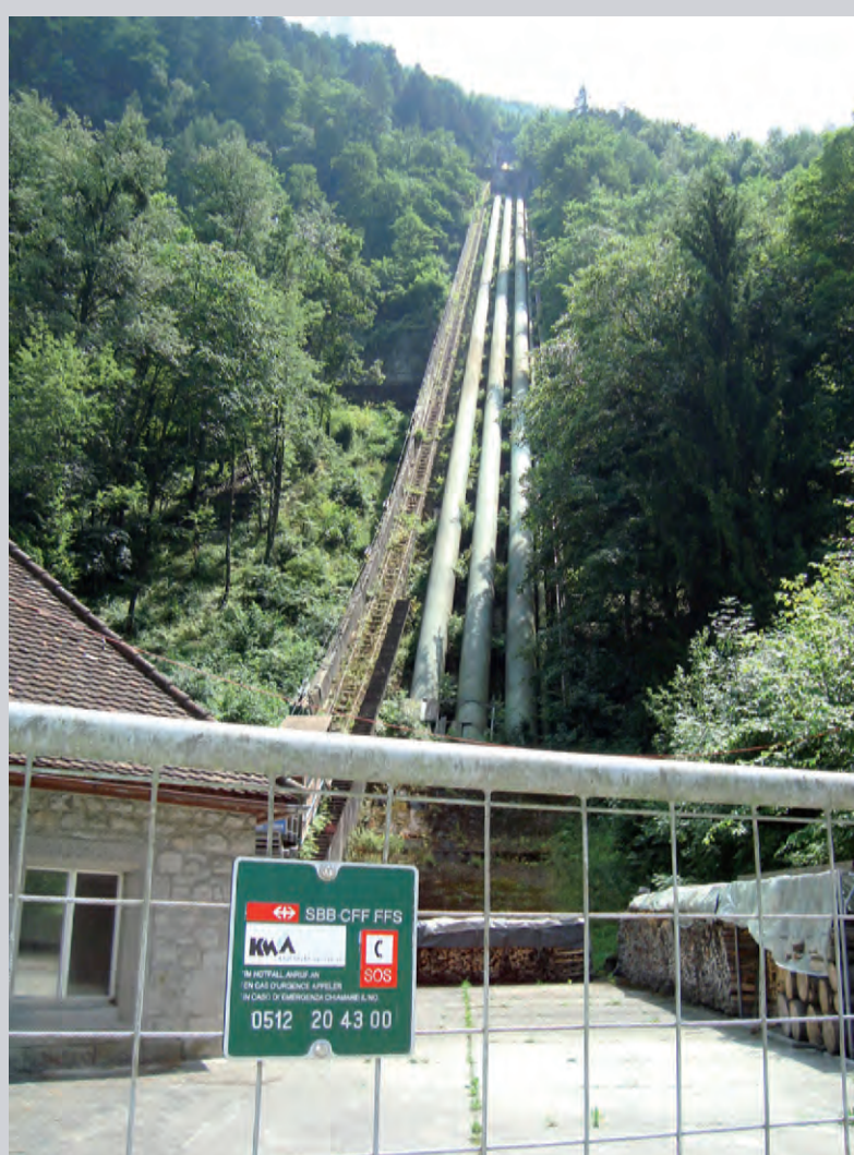
Photo 37. L'entreprise ferroviaire, un producteur d'énergie Vue de la centrale hydroélectrique d'Amsteg ouverte, pour permettre l'électrification de la ligne du Gothard et appartenant aux CFF. Photo K. Sutton, juillet 2010.
