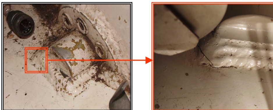
Figure 346 : photographies du palier de point fixe et zoom sur une fissure
