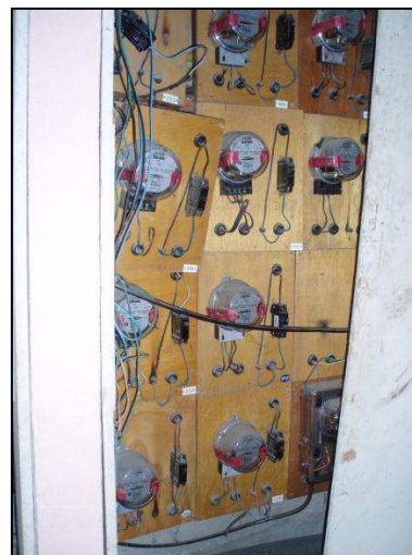
Photo 34 : Les compteurs d'électricité installés par l'entreprise « Light » dans l'immeuble principal de l'invasion.
