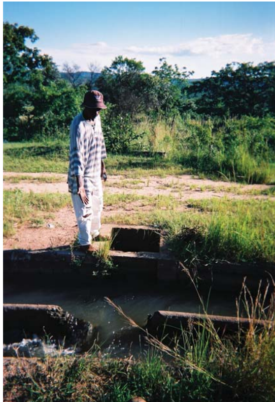
Photo 52. Infrastructures vandalisées à New Forest en réponse à la pénurie saisonnière de l'eau, Afrique du Sud (1)
