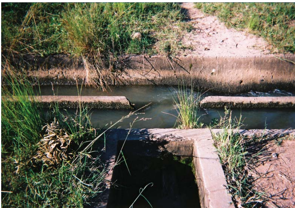
Photo 53. Infrastructures vandalisées à New Forest en réponse à la pénurie saisonnière de l'eau, Afrique du Sud (2)
