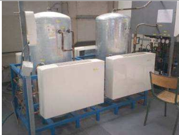
Figure III.2 : Photographie du système de stockage, de distribution d'eaux chaude et froide et de dissipation d'énergie par ventilo-convecteurs
