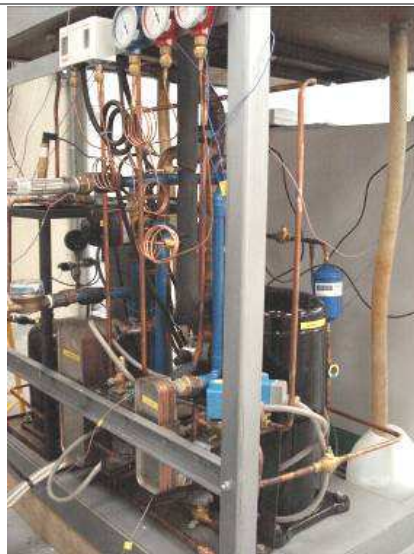
Figure III.3 : Photographie de la partie basse du circuit frigorifique comprenant notamment le compresseur, l'évaporateur à eau, le sous-refroidisseur et la bouteille anti-coup de liquide (en arrière plan)
