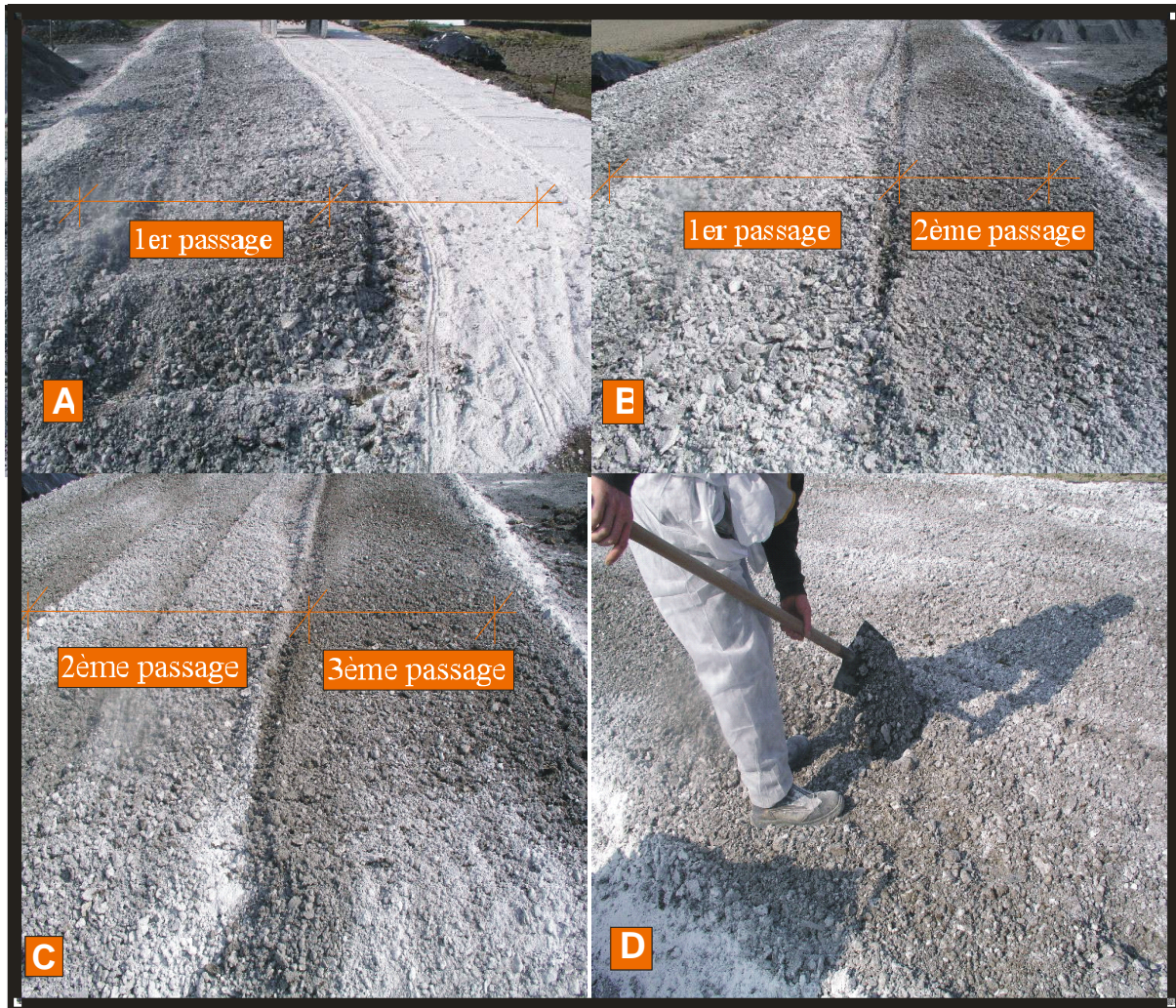
Figure VI-6 : Etat des sédiments après le passage d'engin de mélaxage.
